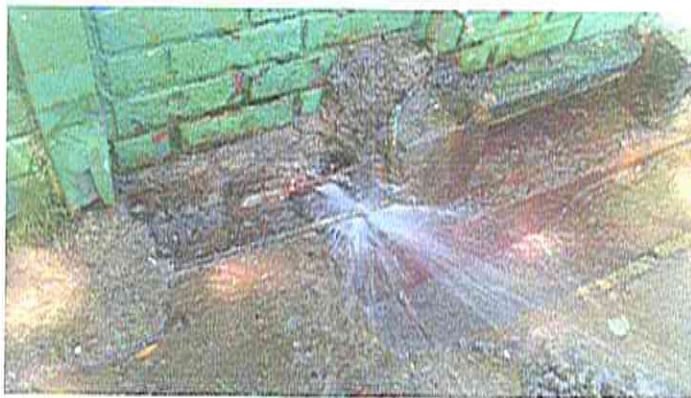
Foto de filtración en colegio CTP
